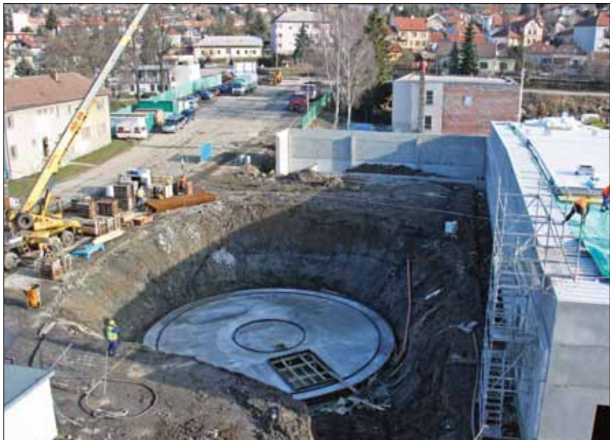
Nádrž na požární vodu pojme více než 600 kubiků vody. Foto: Martina Strnadová
