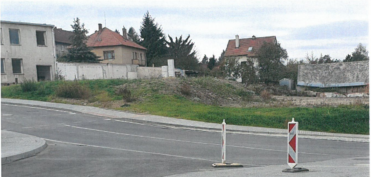
Obrázek 25 - Chybějící vodící linie (podle projektové dokumentace měl být na vnější straně chodníku vyvýšený 6cm obrubník)
