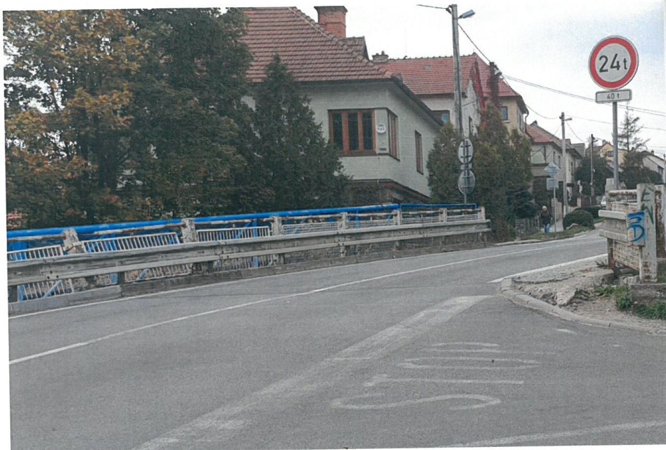
Obrázek 23 - Příčná nerovnost na vozovce – příčná spára zalitá asfaltovou zálivkou
