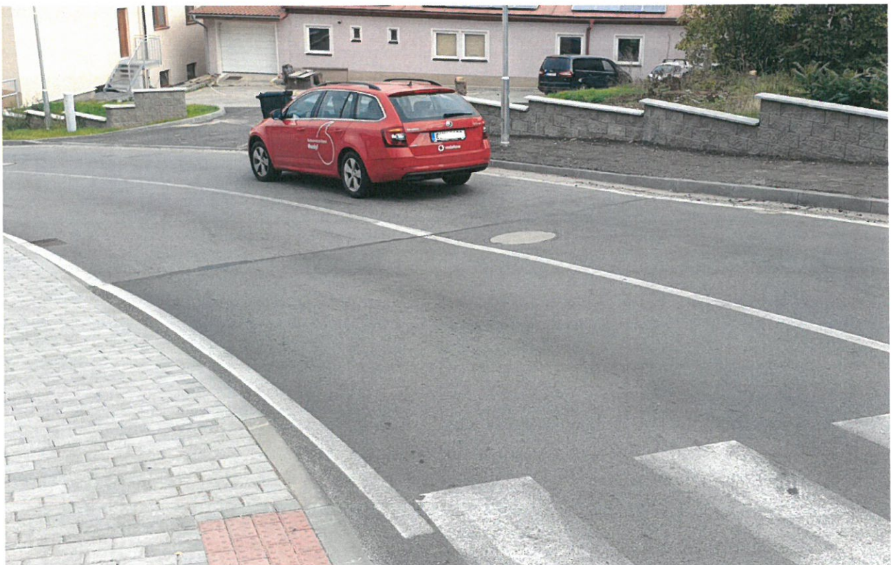
Obrázek 22 - Příčná nerovnost na vozovce – příčná spára zalitá asfaltovou zálivkou
