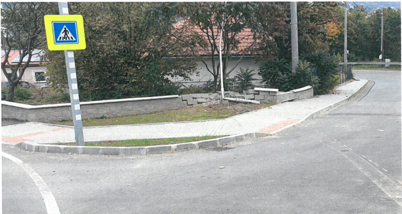
Obrázek 26 - Chybějící vodící linie (podle projektové dokumentace měl být na vnější straně chodníku vyvýšený 6cm obrubník)
