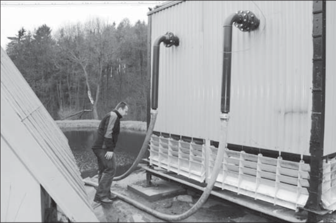
Chladicí věž je zabudována do systému umělého zasněžování. V pozadí rybník, odkud je čerpána voda.
