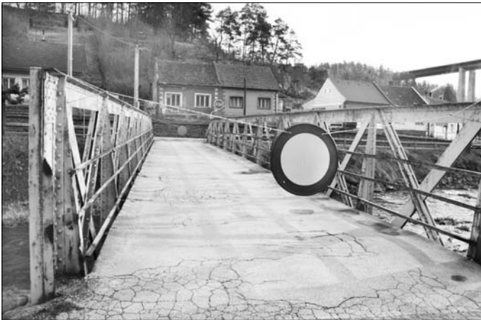
Most u Motorpalu je zavřený od poloviny prosince loňského roku, protože je v havarijním stavu. Vozový povrch je místy propadlý a kovová konstrukce zcela zkorodovaná. Foto: Martina Strnadová
