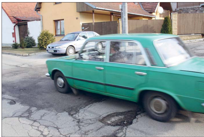
Výtluky v silnici na Františkově ve Velkém Meziříčí.
