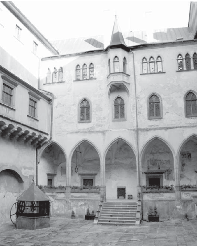
Vnitřní nádvoří zámku letos čeká oprava fasády. V nejhorším stavu je východní stěna s arkádami.
