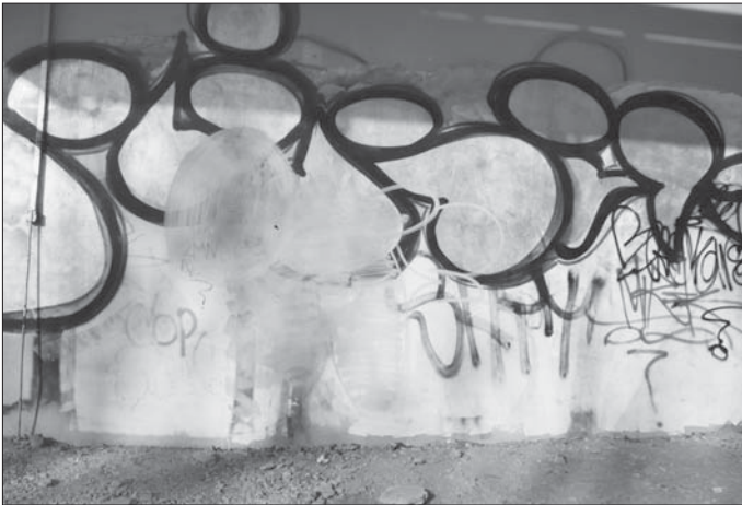
Nedokončené „dílo“ sprejerů na pilíři dálničního mostu v lokalitě K Rakůvkám. Foto: městská policie
