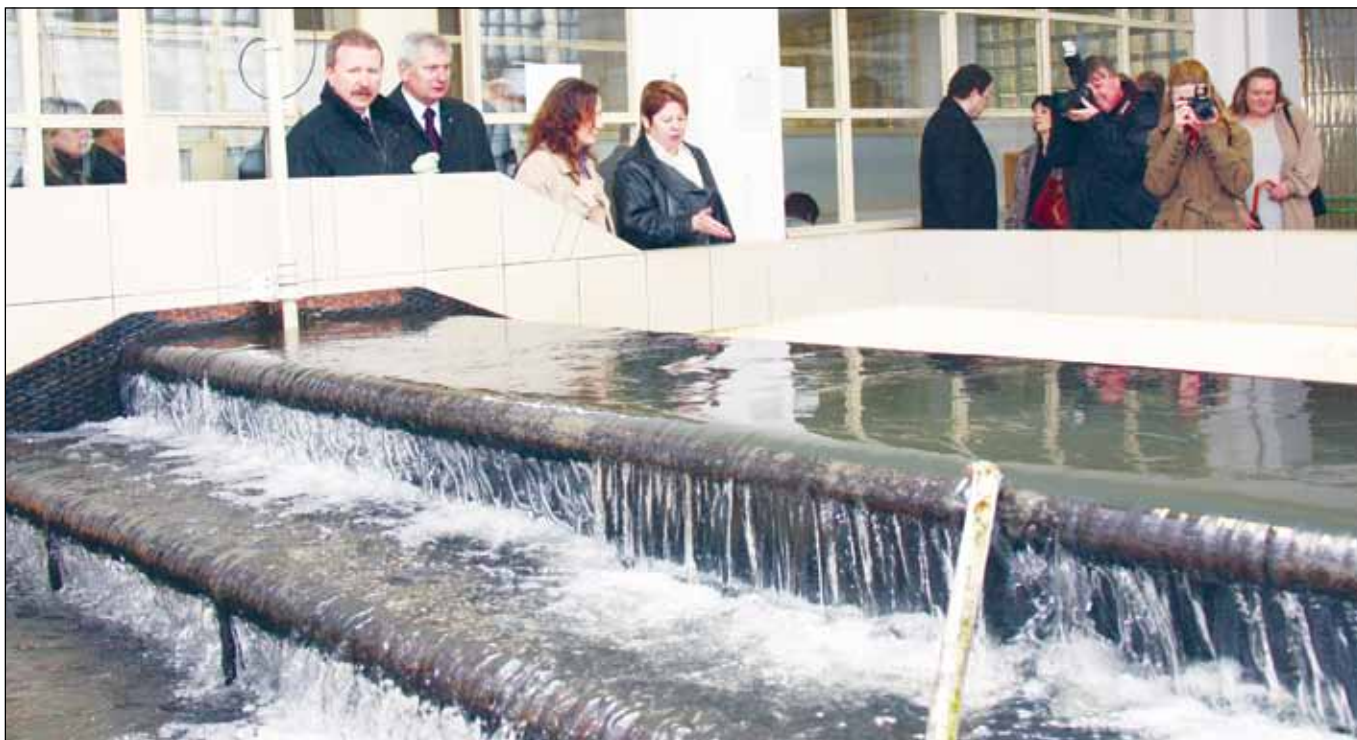
Účastníci slavnostního zahájení rekonstrukce úpravy vody Mostiště si mimo jiné prohlédli i její aktuální stav. Na snímku je kaskáda, kde dochází k provzdušnění surové vody a následnému nadávkování koagulantu. Foto: Martina Strnadová
