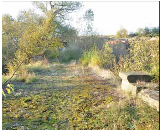
Horní část mostu, po níž se kdysi jezdilo, je nyní zarostlá trávou. Foto: Martina Strnadová
