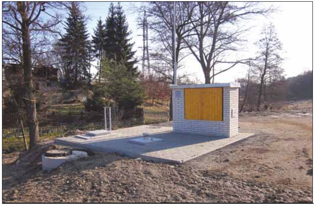
Čerpací stanice v Oslavici. Foto: archiv správce stavby
