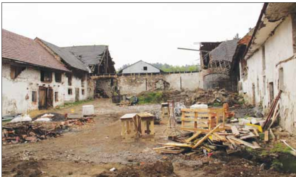
Nádvoří usedlosti a zadní trakt budov na opravu teprve čekají, budou-li další peníze z Evropské unie. Foto: Martina Strnadová
