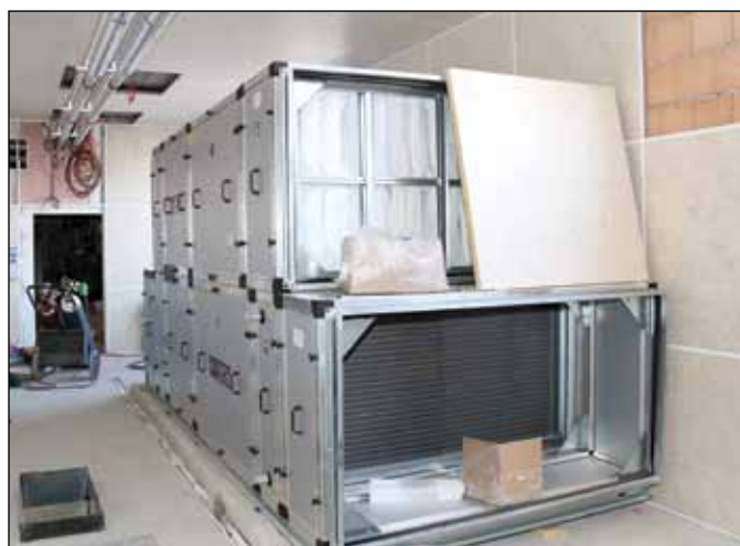
Centrální místnost pro vzduchotechniku. Foto: Martina Strnadová
